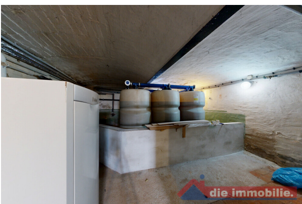
Erneuerte Öl-Brennwertheizung aus dem Jahr 2024
