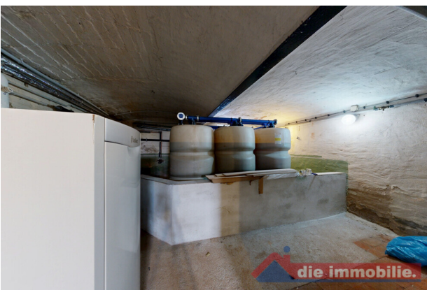
Erneuerte Öl-Brennwertheizung aus dem Jahr 2024
